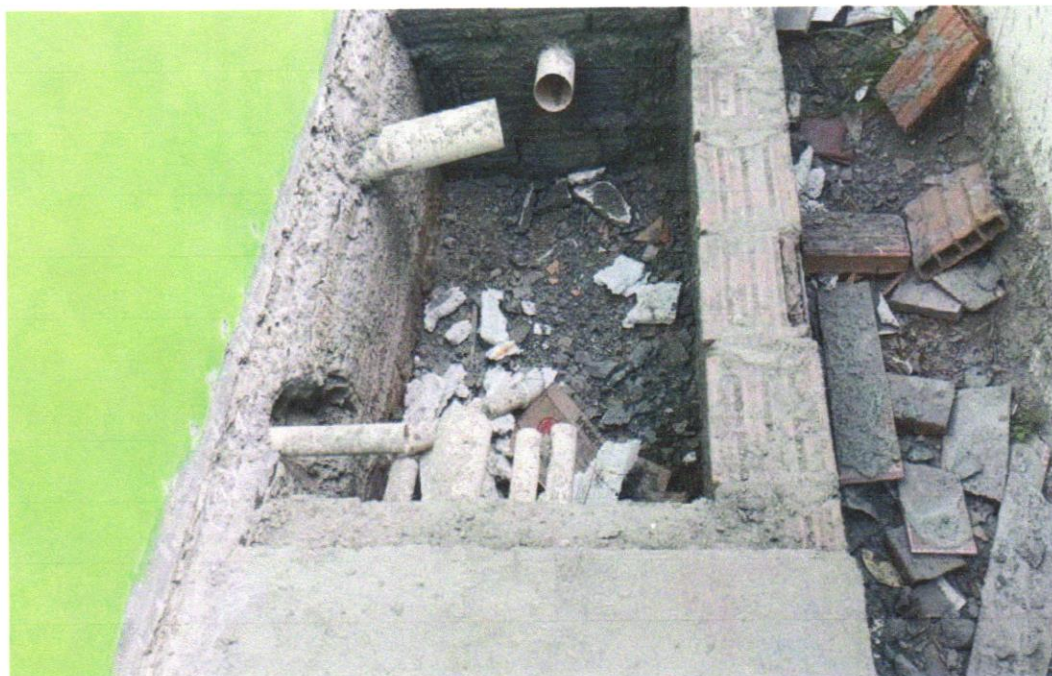
Foto 14 - Sumidouro paredes com blocos cerâmicos 6 furos e dimensões internas de 1,75 x 1,00 x 1,00 m
