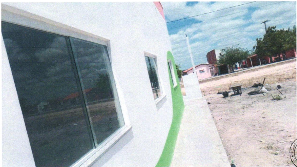
Foto 16 - APLICAÇÃO MANUAL DE PINTURA COM TINTA LÁTEX ACRÍLICA EM PAREDES, DUAS DEMÃOS. AF_06/2014
