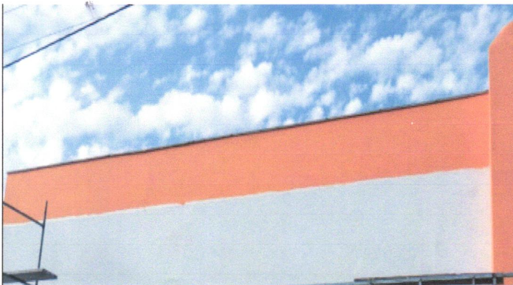
FOTO 26 – Chapim de concreto pré-moldado
