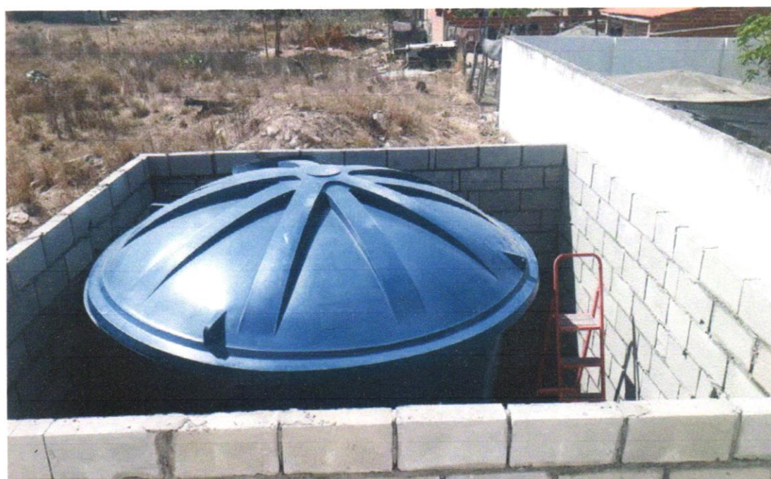
Foto 06- RESERVATÓRIO DE POLIETILENO 10.000 LITROS
